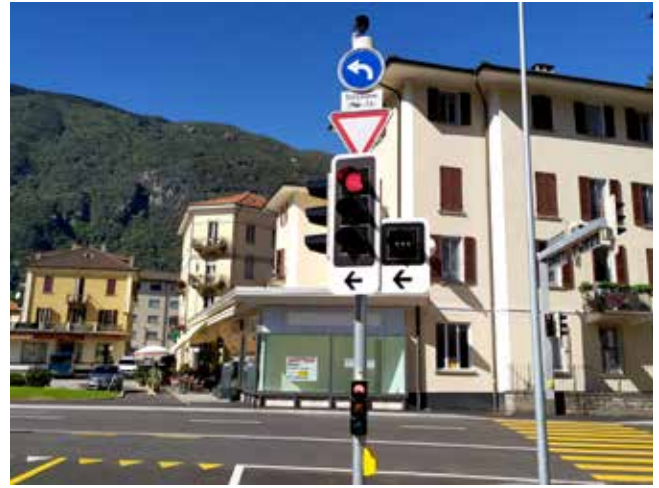
Fig. 3 Feux de circulation avec capteur thermique situé en hauteur.
