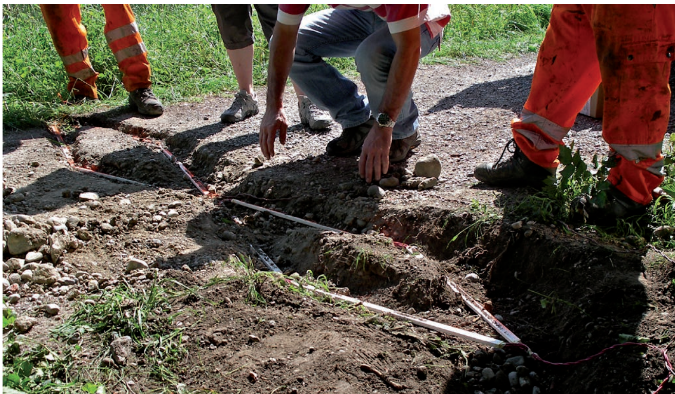
Abb. 3: Einbau eines kombinierten Velo- und Fussgänger-Zählgeräts am Limmatufer in Zürich 2010
